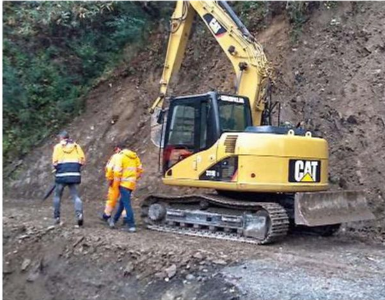
I tecnici di via Veneto al lavoro sulla provinciale 51 di Vernazza. Nel tondo, il dirigente della Provincia Gianni Benvenuto
