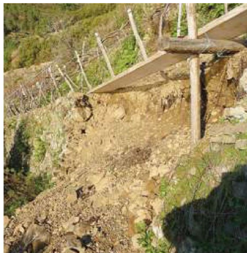
Muretti a secco distrutti dal passaggio dei cinghiali alle Cinque Terre
