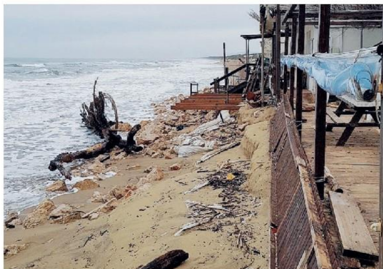
I danni causati dall'erosione
