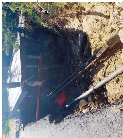
Il cedimento sul lungomare di Sabaudia
