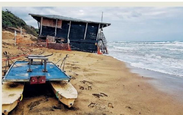
I danni causati dall'erosione
